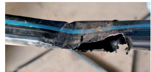
▲ Dégâts de rongeurs
